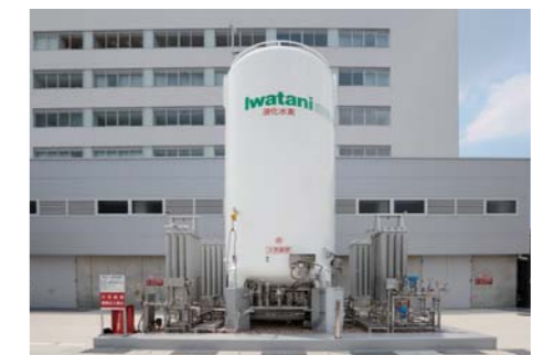
液化水素貯槽(中央研究所)
